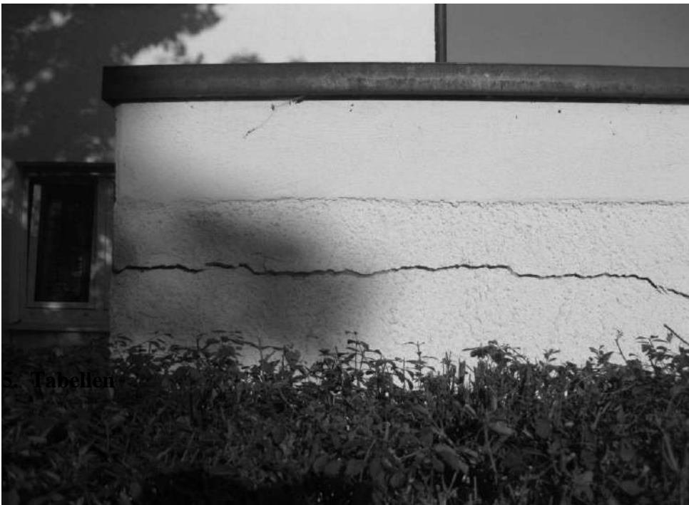
Abb. 20: Das Bild zeigt einen Garagenanbau an einem Haus in Ludwigsburg-Poppenweiler. Ursache für den großen Riss ist vermutlich der bindige Lehm Boden, der in trocknen Jahreszeiten tief ausgetrocknet und geschrumpft ist. Mit ursächlich könnten auch wasserverbrauchende Bäume in der Nähe der Garagenwand sein. Die flach gegründete Garagenwand hat sich mit dem schrumpfenden Boden gesetzt. Solche Schäden sind im Ludwigsburger Raum und im Strohgau wegen der weitverbreiteten Lehm Böden nicht selten.
